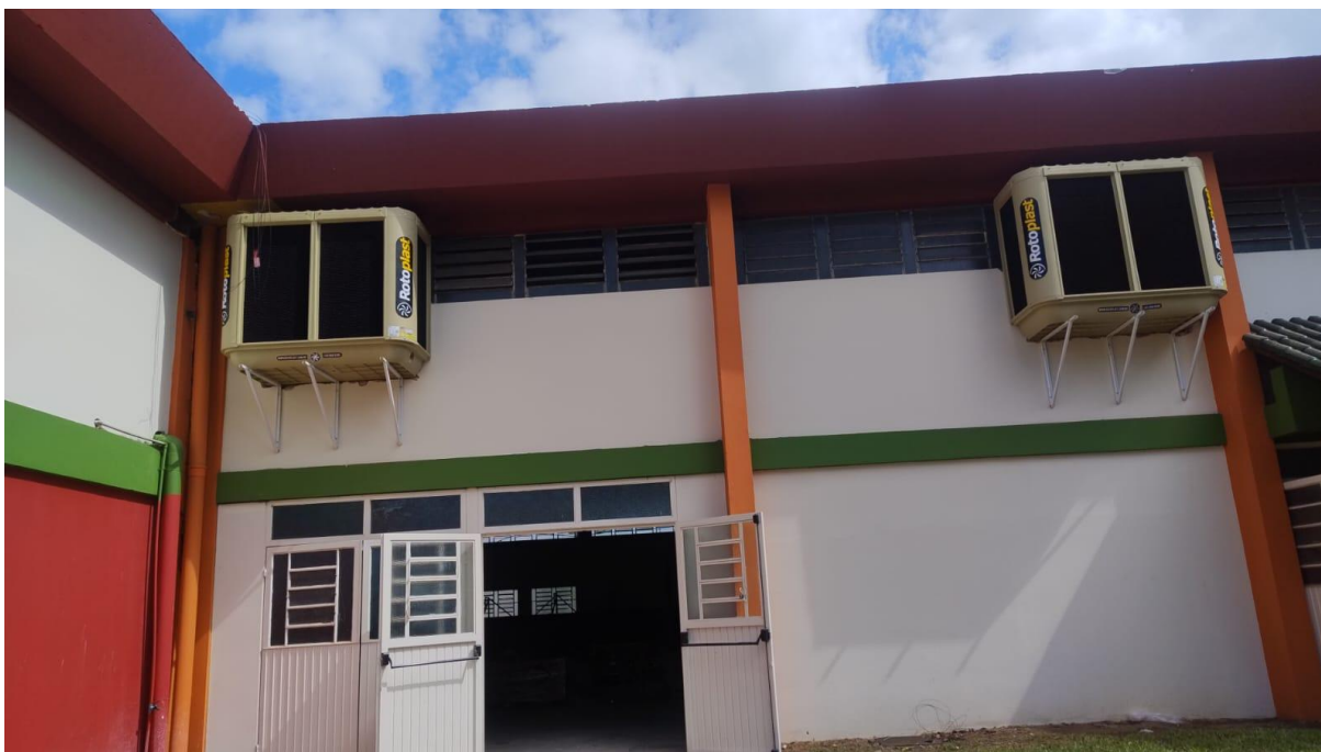
26/02/2026 — Fachada lateral do ginásio com aparelhos de ar-condicionado instalados.
