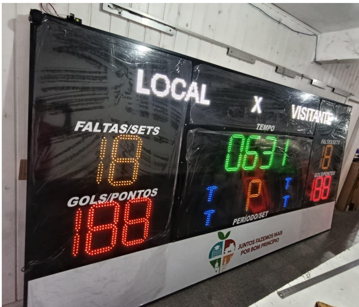
13/03/2026 — Placar eletrônico, sendo testado antes da retirada do equipamento antigo.
